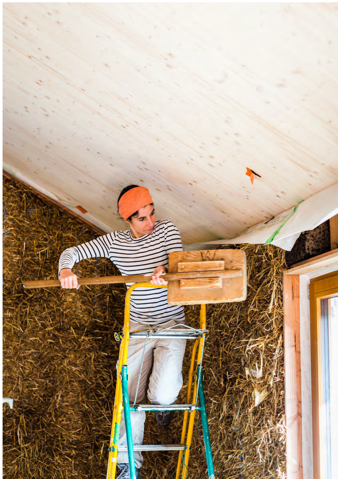
Chantier participatif pour la mise en place des bottes de pailles dans la maison Keravel à La Roche-Jaudy (Côtes d'Armor)
