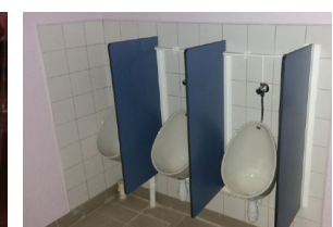
Équipements sanitaires de remplacement Non-références
