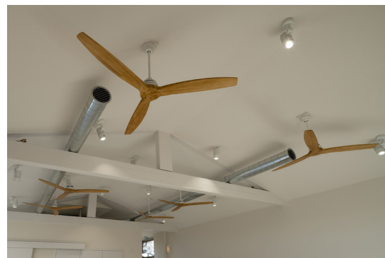
TRANSFERT DE L'AIR RECHAUFFÉ PAR LES GAINES
