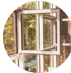
Fenestration ouvrante (ventilation naturelle)
