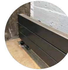
Chauffage radiant hydronique
